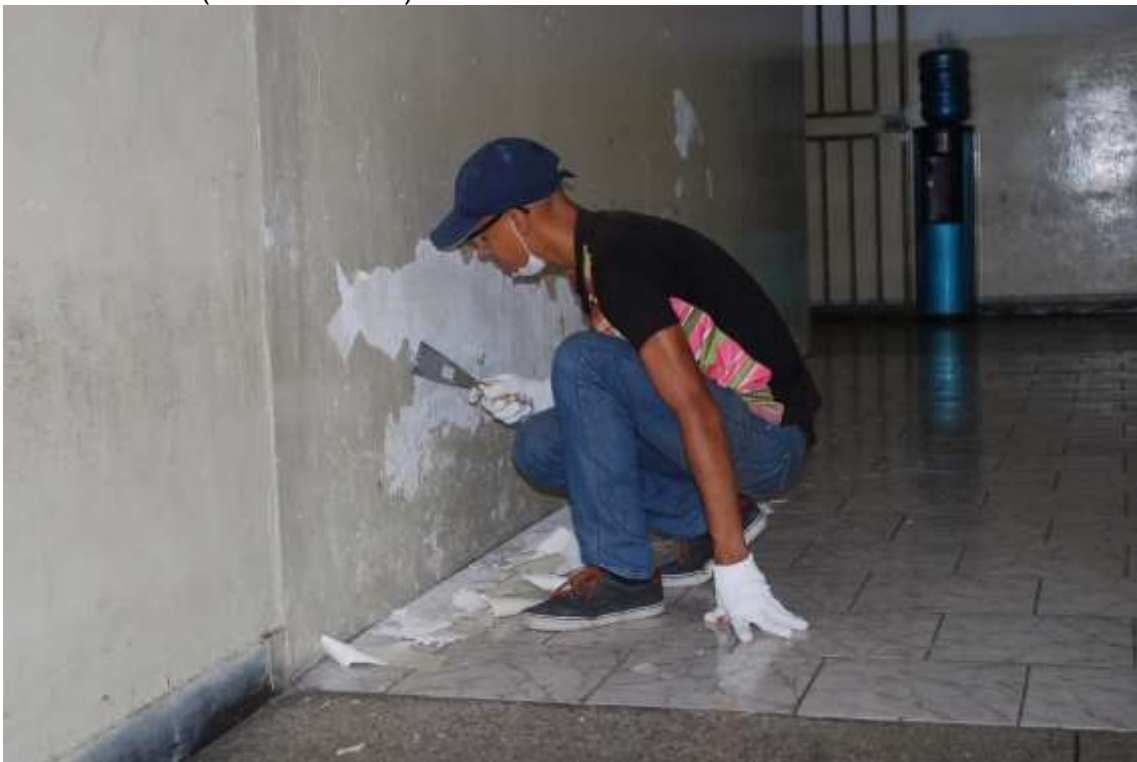
FOTO No 3: Un estudiante realizando la reparación de paredes de la UPTT. (Foto Martín Hidalgo)
